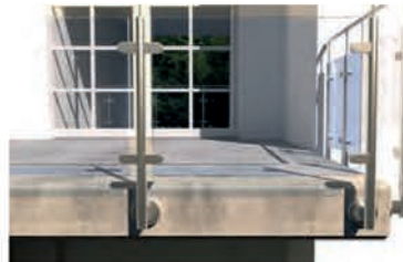
Barandales de balcón
